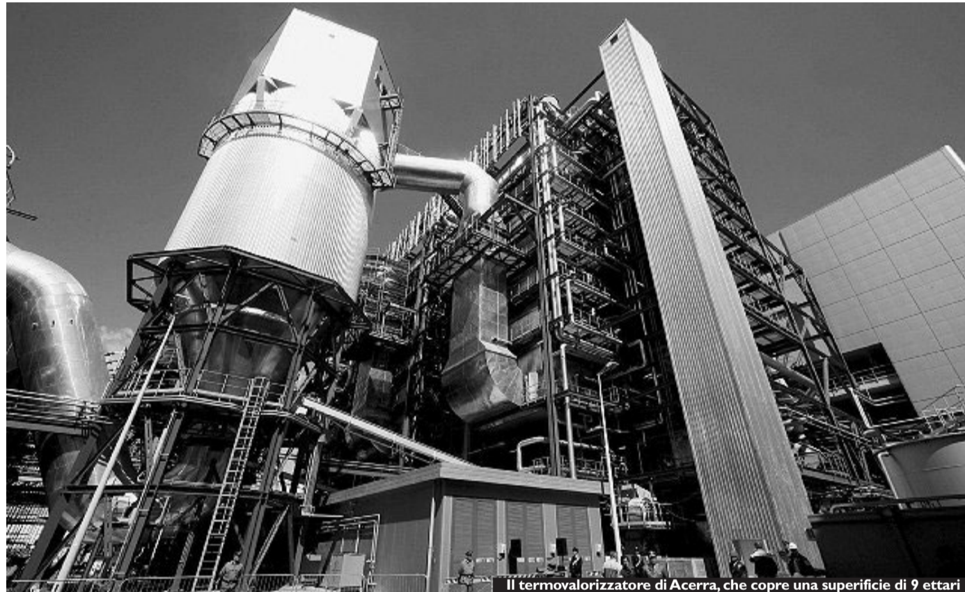
Il termovalorizzatore di Acerra, che copre una superficie di 9 ettari
